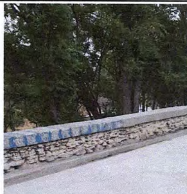
Foto 3: Repello del muro medianero.
